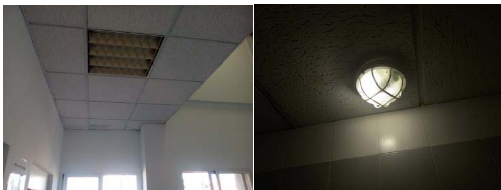
Imagen 7. Luminarias instaladas en el centro
